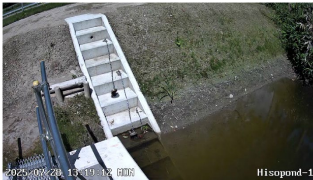
ため池の取水口の画像。ゴミ詰まりを 24 時間リアルタイムで監視できる。 農家さんの感想:「頻繁に見に行ってゴミをさらっていたがカメラで状況を確認できるので楽になった」
